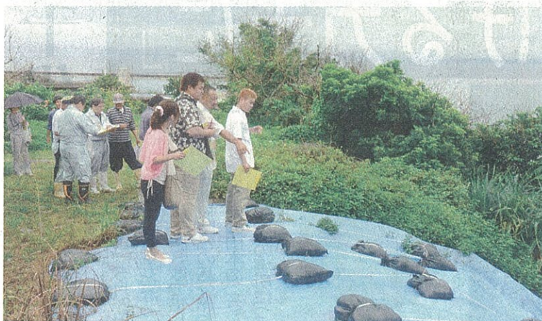
崩れた遊歩道を視察する参加者ら＝うるま市津堅島のキャロット愛ランド遊歩道
